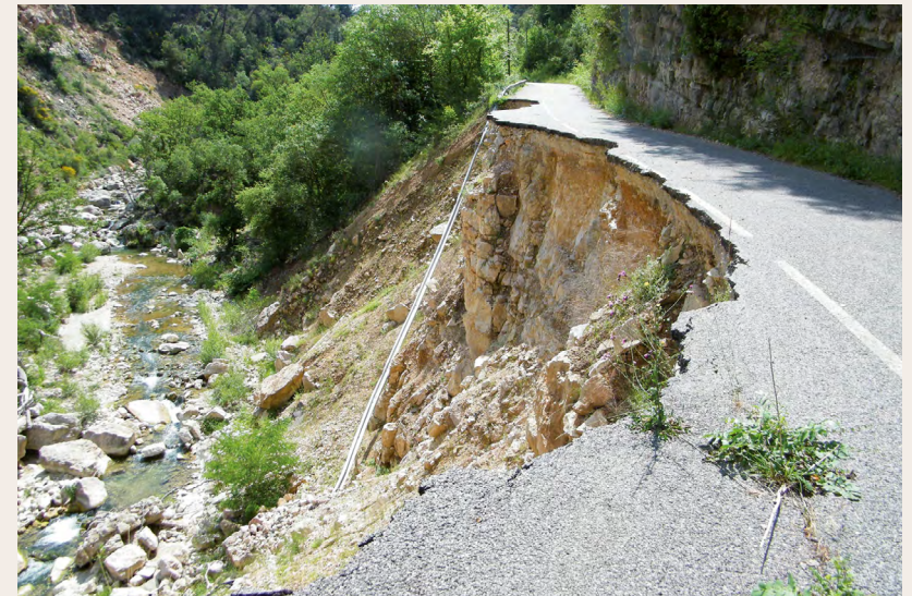
Effondrement de chaussée - © Cerema
