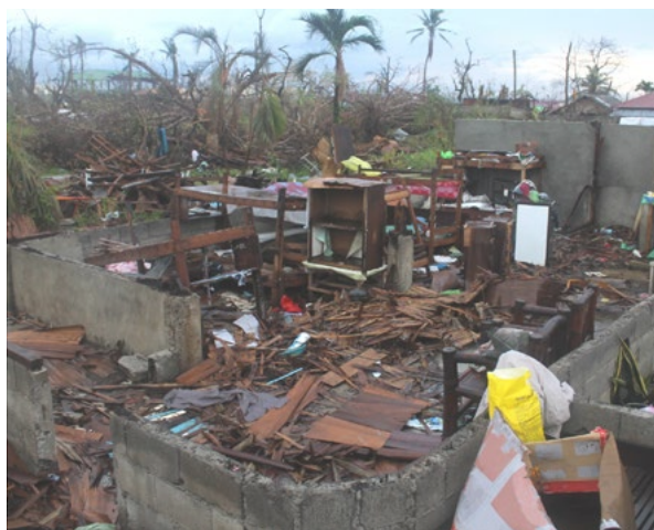
Maison détruite par un orage. Photo par Acrylik.
